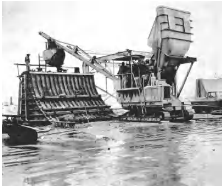
Figura 3. Seção do muro de Galveston (Texas, EUA) sendo preenchida com concreto em 1959, durante sua expansão. Fonte: USACE, 1981.
